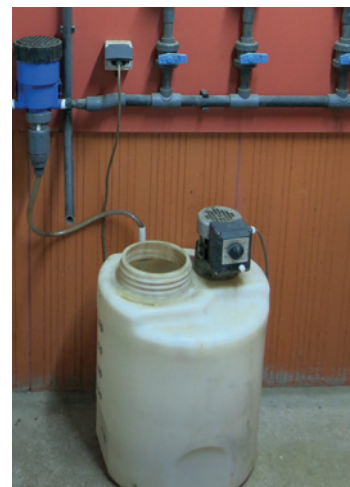
Bac de solution mère d'une pompe doseuse
