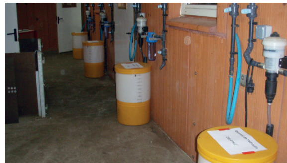
Photo 1 : Administration d'antibiotiques par pompe doseuse
